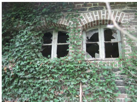
Vitres cassées sur les fenêtres
