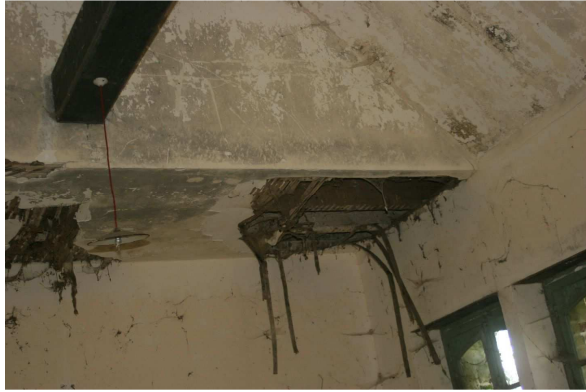
Plafond très dégradé
